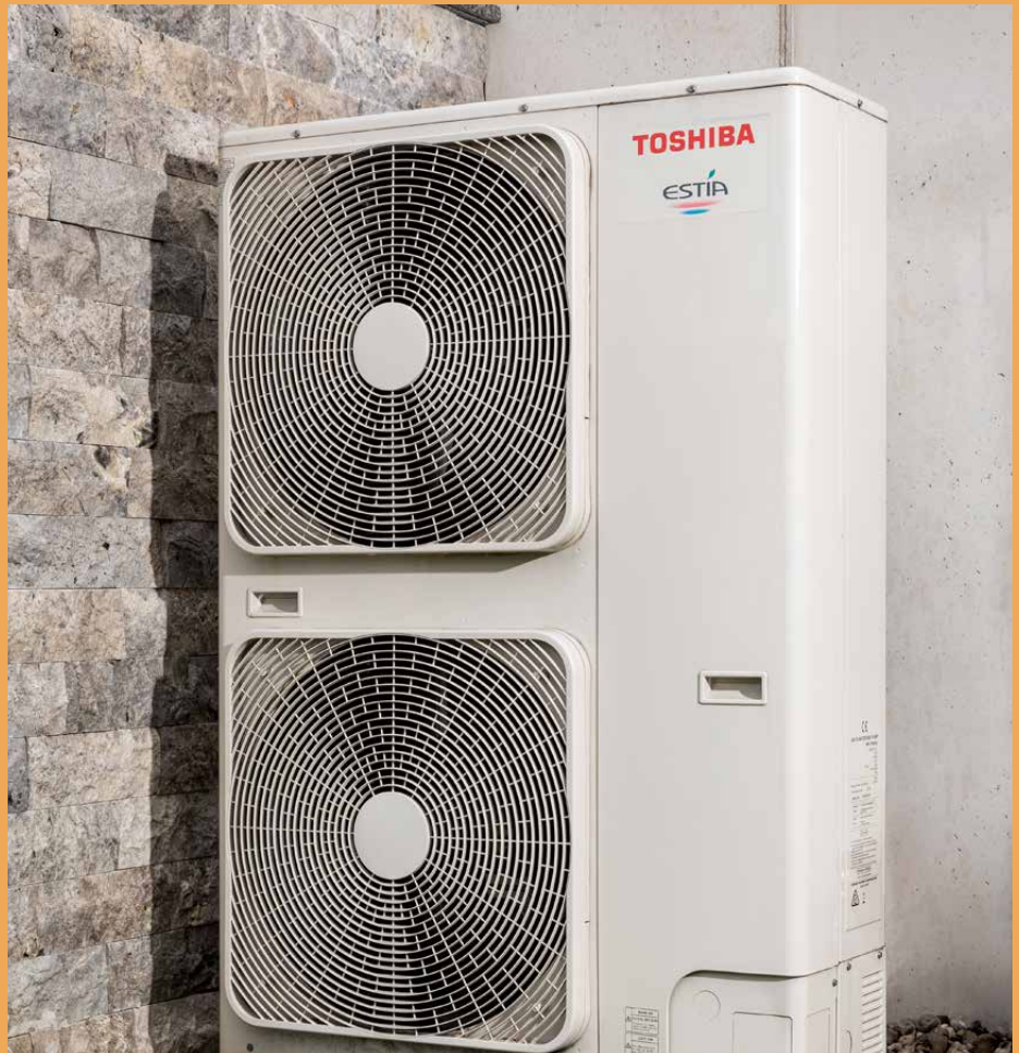
Einfamilienhaus, Hasenbichler Kälte- und Klimatechnik
